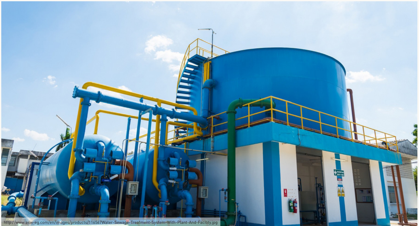
Endüstriyel Atıksu Arıtma Tesisi
