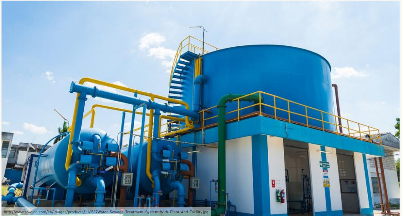
Endüstriyel Atıksu Arıtma Tesisi
