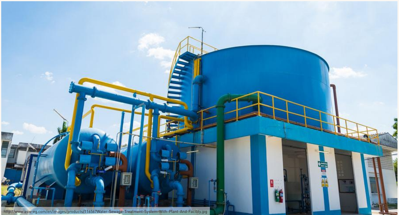
Endüstriyel Atıksu Arıtma Tesisi
