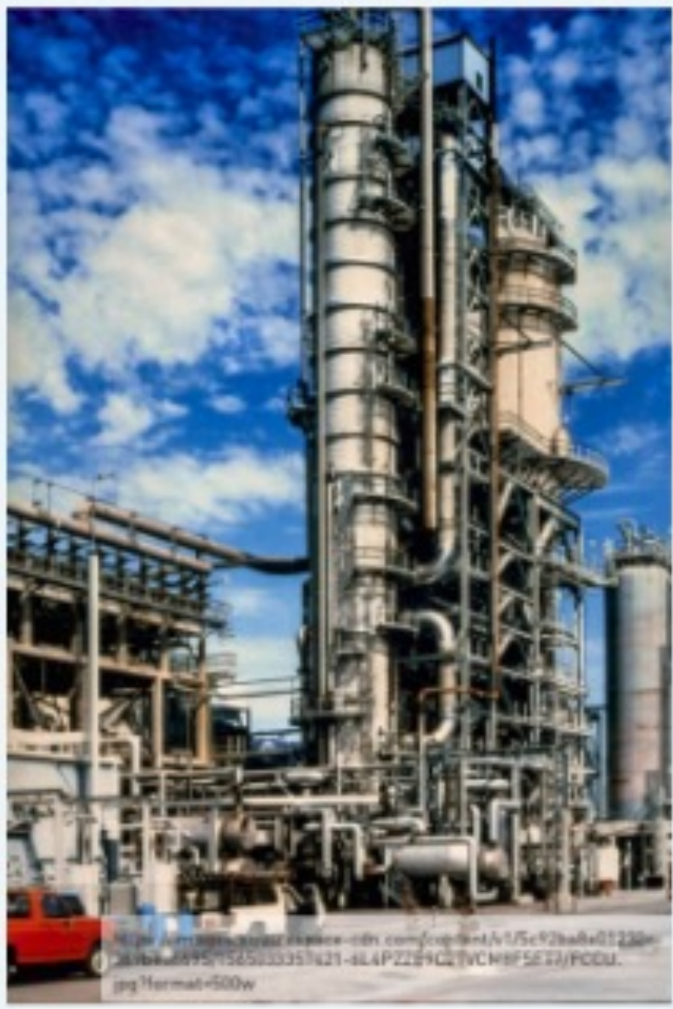
Kimya Sektöründe Kraking Ünitesi
