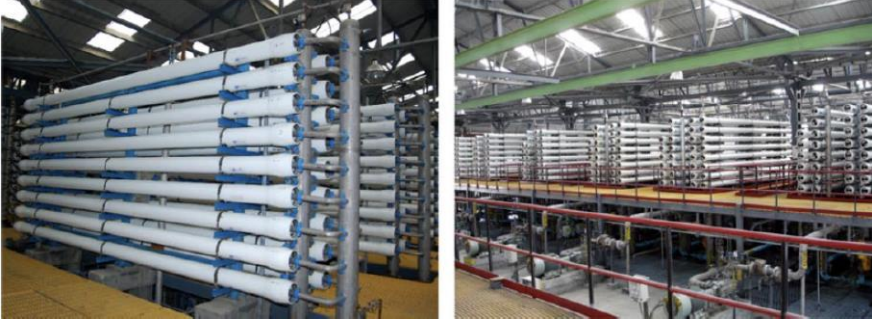
Şekil 5-52 Panipat rafinerisi RO üniteleri [122]
