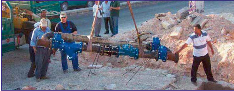
Şekil 2. Basınç düşürücü vana (PRV) montajı (GWLR, 2011)
