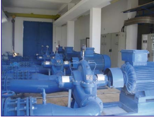
Şekil 2.1. Su kayıplarının azaltılması ile terfi edilen su hacmi azalır ve buna bağlı olarak enerji maliyetleri azalır.
