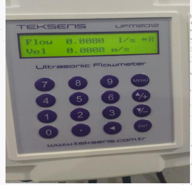
29-A Nolu Alt Bölge Depo Çıkışı Debimetre Paneli
