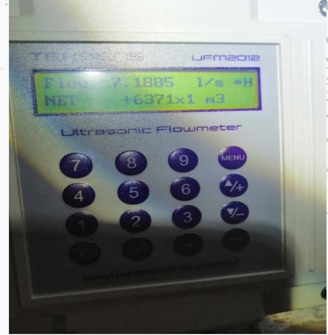
22-A Nolu Alt Bölge Depo Çıkışı Debimetre Paneli
