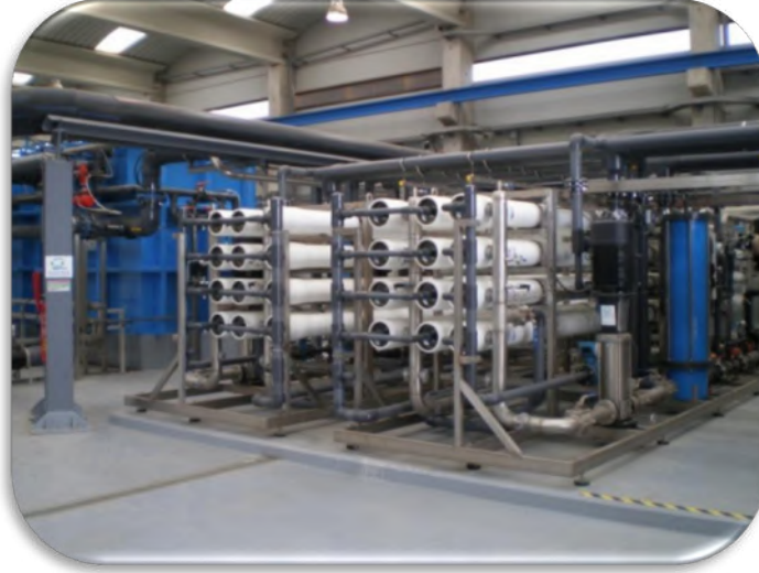
Deniz suyu giriş bariyeri için gelişmiş su ıslah tesisi
