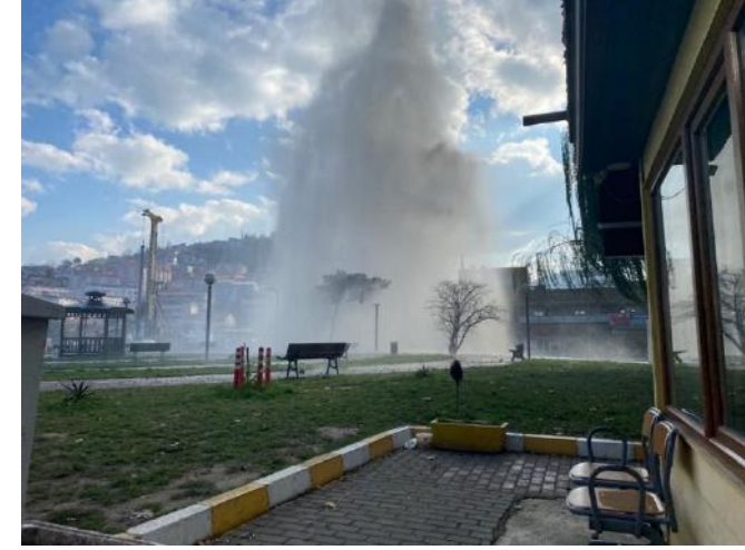
Şekil 25. Alt yapı çalışması sırasında patlamış su borusu
