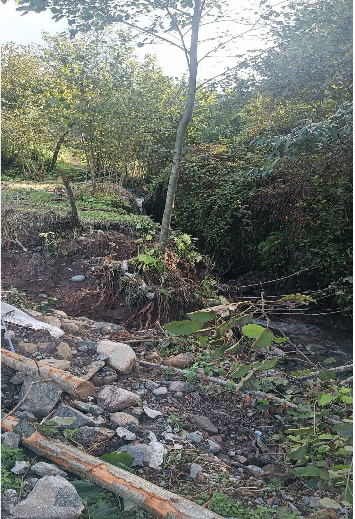
16.09.2024 tarihinde meydana gelen taşkın sebebiyle yıkım ve rüşup birikintisi
