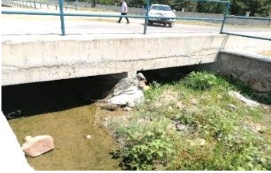
Şekil 27- Yetersiz kesitli sanat yapısına ait görüntü
