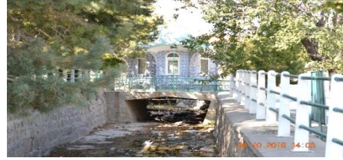
Şekil 5- Vatandaşlar tarafından taşkın tesisi üzerine yapılan müdahaleye ait görüntü
