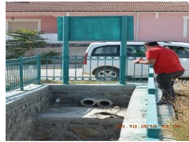
Şekil 14- Taşkın koruma tesisinin memba kesiminin aktif çalışmamasına ait görüntü
