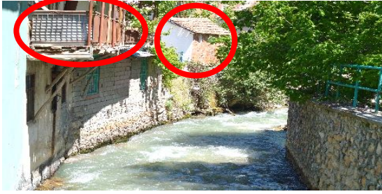
Şekil 4- Kamulaştırması yapılamayan ev duvarlarının taşkın tesisi duvarı görevini yaparak risk teşkil etmesine ait görüntü
