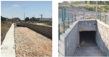
Şekil 22- Cihanbeyli İlçesi taşkın koruma tesis güzergâhı üzerinde bulunan, Ankara-Konya karayolunu dik kesen menfez yapısının kesit yetersizliğini oluşturmasına ait görüntü
