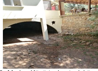
Şekil 10- Maden Köyü taşkın tesisi üzerine yapılan vatandaş müdahalesine ait görüntü
