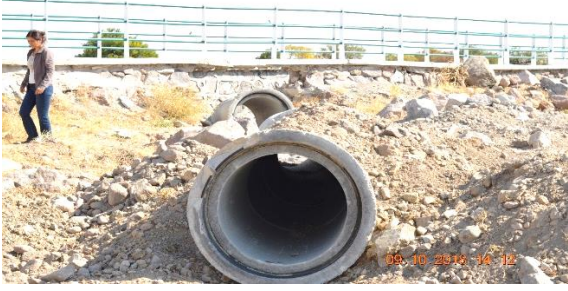
Şekil 6- Vatandaşlar tarafından taşkın tesisi üzerine yapılan müdahaleye ait görüntü
