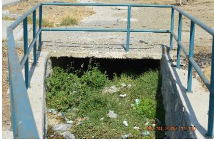
Şekil 15- Zincirlikuyu Mahallesi taşkın koruma tesisi kanal içerisinde taşkına sebep olabilecek kadar biriken rüsubatın görüntüsü
