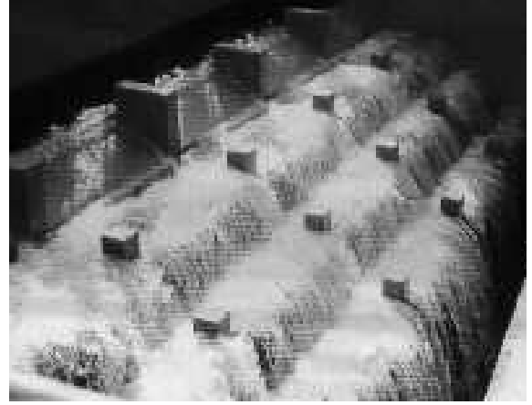
Fotoğraf 1 - Basamaklı kaskat havalandırıcı (Diyarbakır içmesuyu arıtma tesisi)
