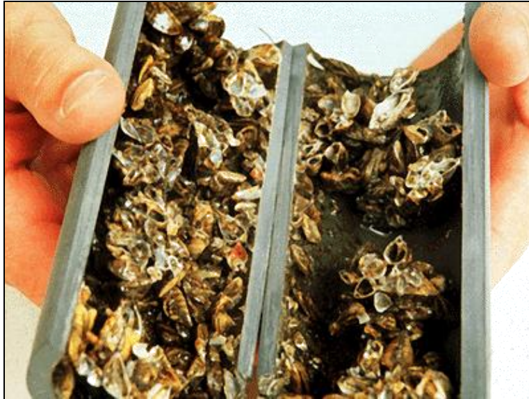
Şekil 6 - Su borularında zebra midye sorunu
