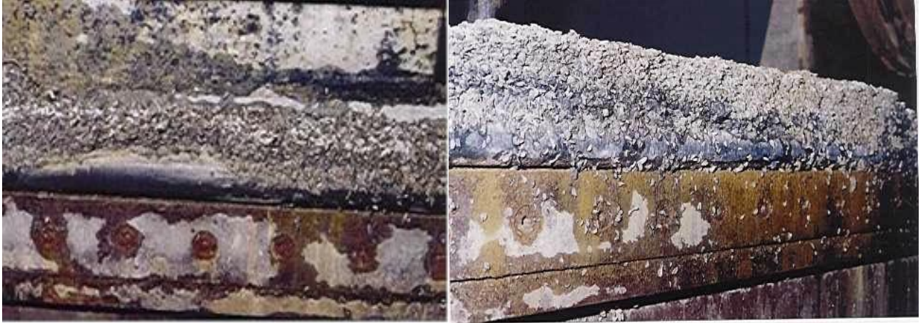
Şekil 27 - Şanlıurfa tünelleri kapaklarında zebra midye sorunları
