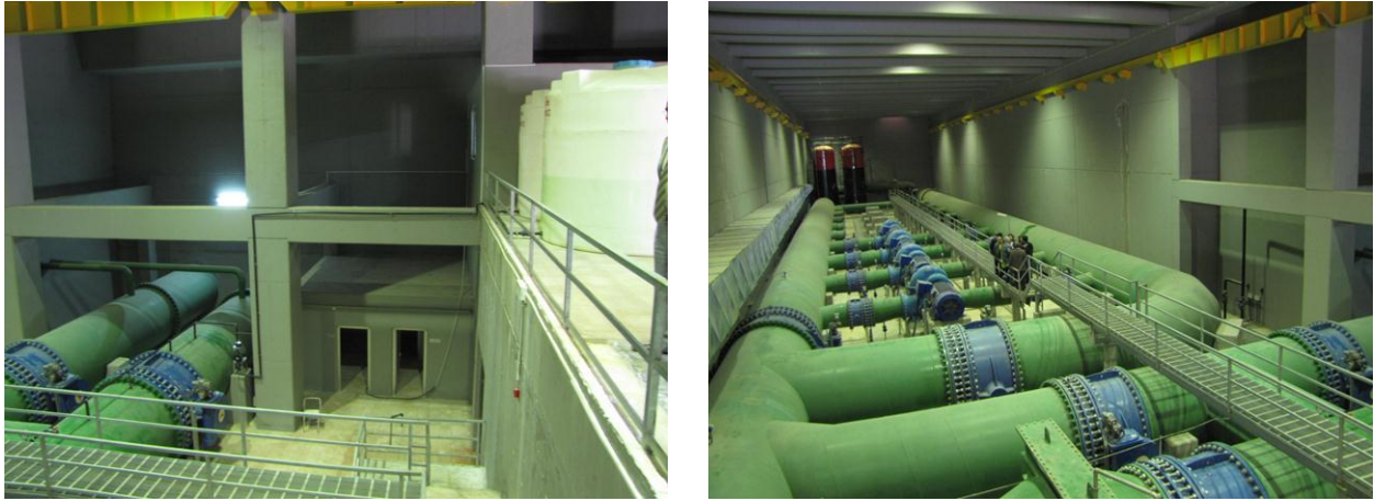
Şekil 25 - Şanlıurfa içmesuyu ham su ön klorlama sistemi
