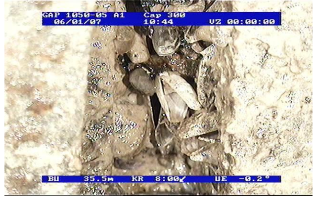
Şekil 22 - 1050-05 hattı ctp boru bağlantılarında zebra midye
